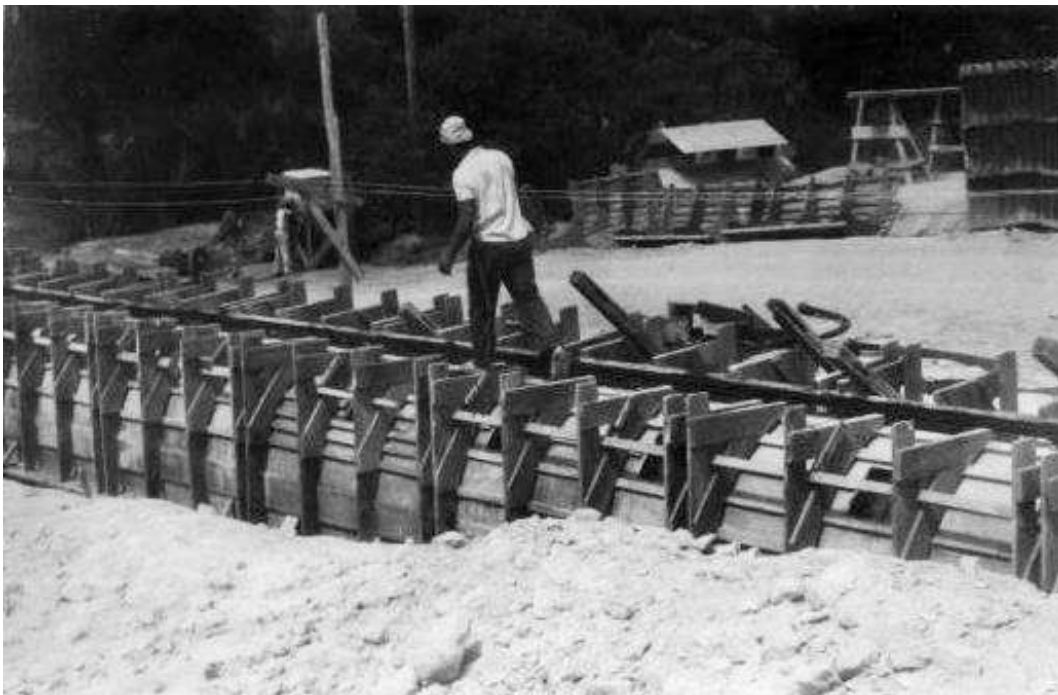
Foto 1.1 - Vista parcial das formas da segunda fase de moldagem de um dos tubos (1964).
