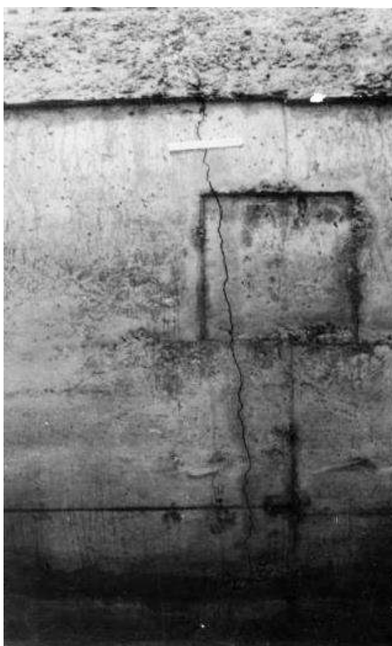
Foto 1.3 - Vista de uma das fissuras nos tubos da adutora do Joanes.
