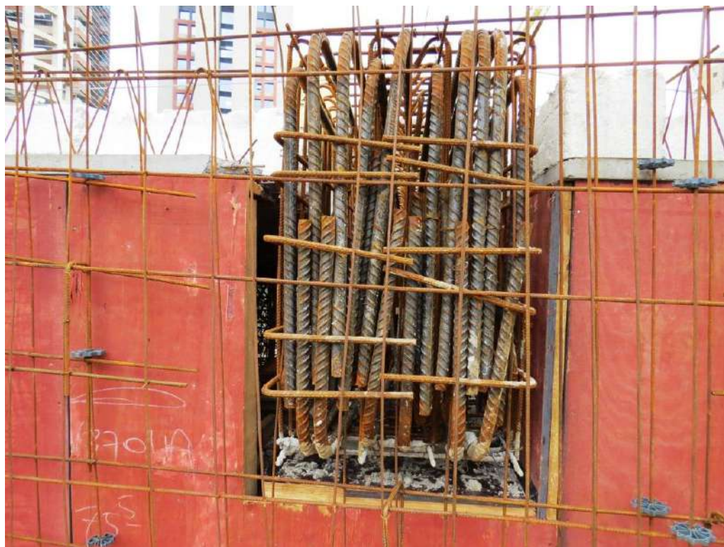
Figura 8.2 – A falta de espaço para assentamento dos insertos da viga metálica evidencia a inconsistência entre os projetos da estrutura de concreto e da estrutura metálica.
