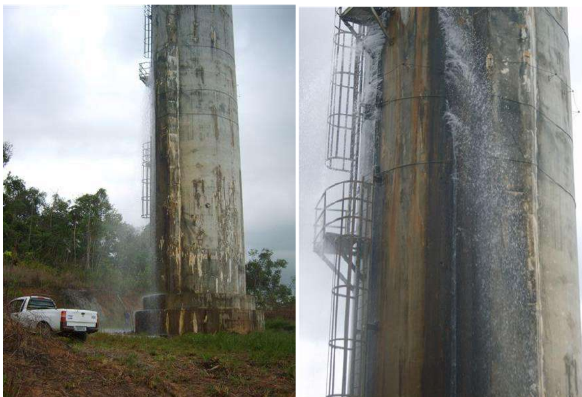
Figura 17.1 – Vazamentos na chaminé da adutora do Joanes II
