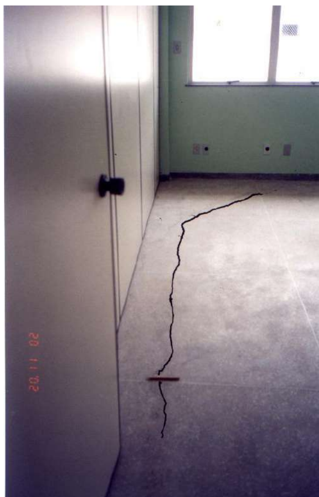
Foto 7.2– Trincas na face superior de uma laje. As trincas foram acentuadas na foto com marcador para facilitar sua visualização.
